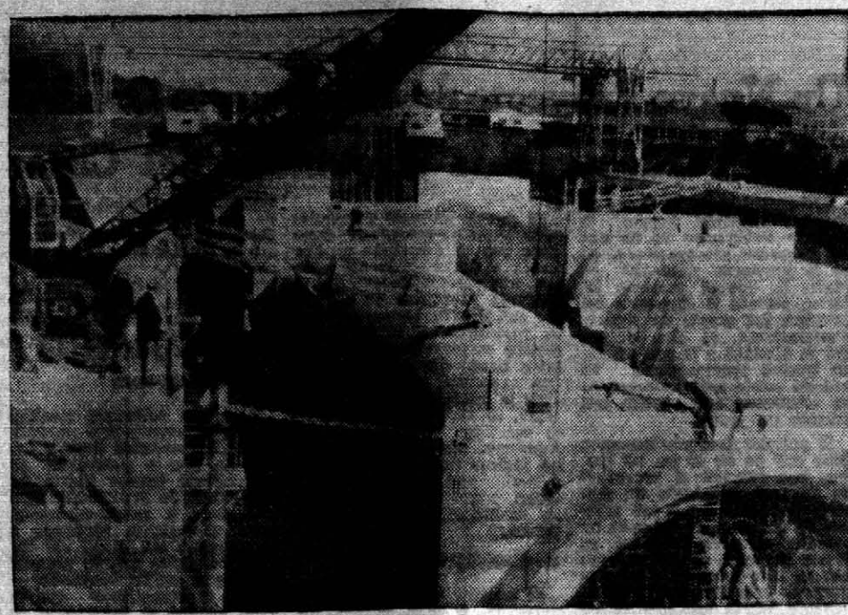
GIGANTESCOS CAÑOS — Se están dando los últimos retoques a la terminación de los 4 caños de la segunda serie, que se construyen en dique seco, en el obraje Paraná. Previa la prueba de impermeabilidad, esperarán en la isla Santa Cándida para ser sumergidos en el lecho del río.
